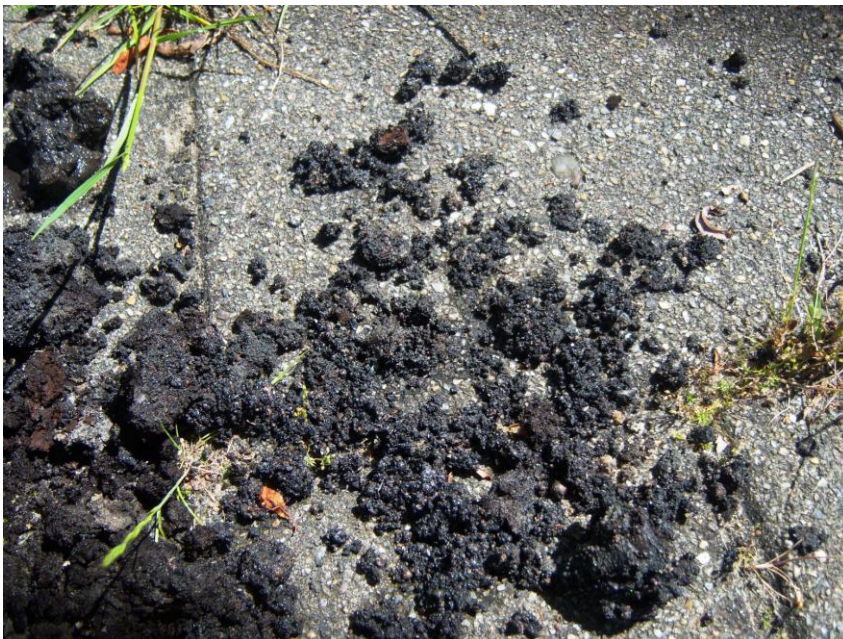
Afbeelding 9. "Sintels" zoals aangetroffen in boring 10.
